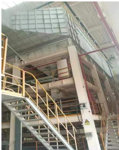
图 3 项目运行现场
