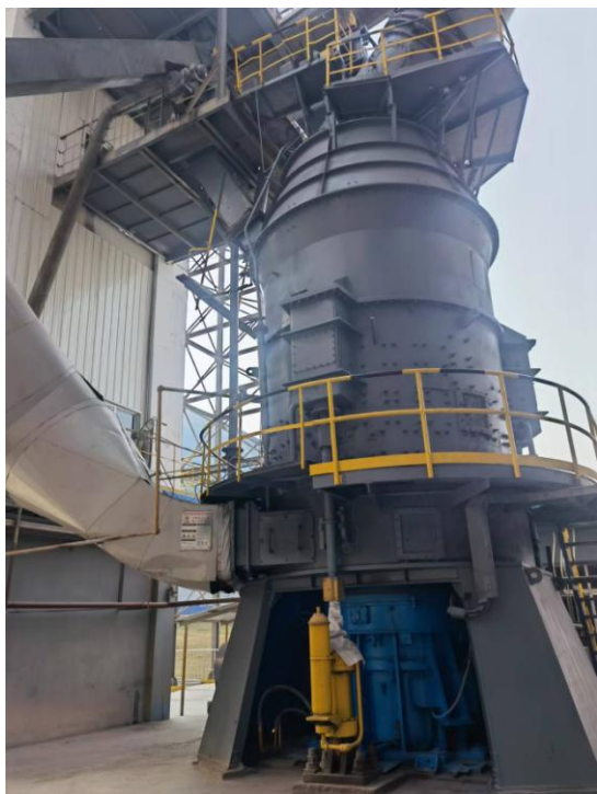
图 4 改造前煤立磨 MVM2900H
